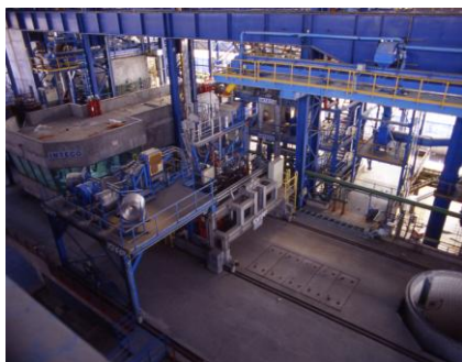
Vakuumentgasungsanlage mit Deckelwagen
